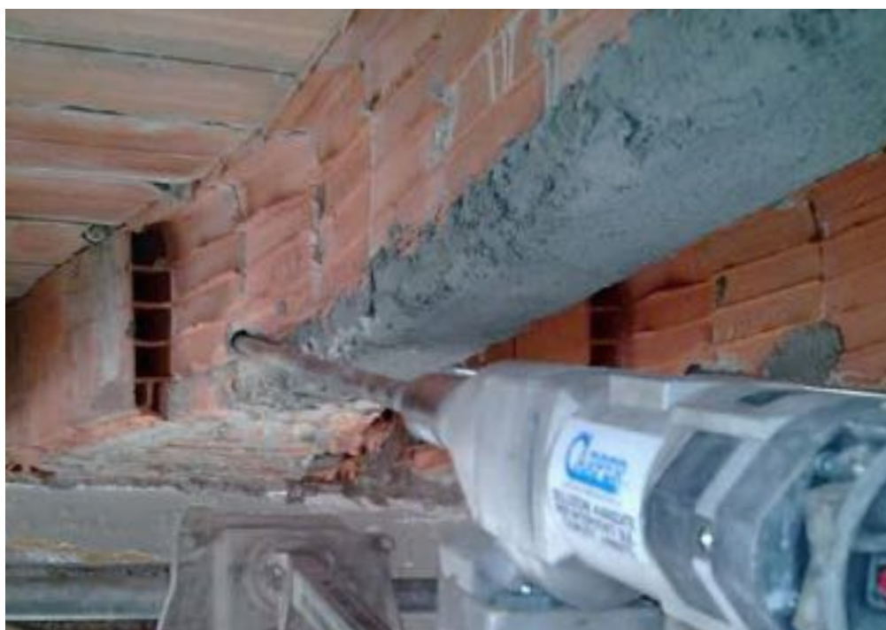
Fig.08 | Immagini del cantiere di restauro del Palazzo della Civiltà. In alto: volta del loggiato ad un foglio di laterizio con tensori metallici. In basso: solaio tipo "Bidelta".
