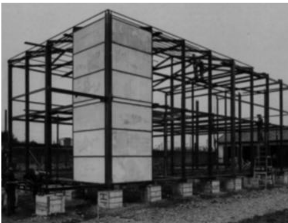
Fig.118 | Fase di costruzione del brevetto "Invulnerabile" esposto alla Fiera del Levante a Bari (1937) e progettato per la realizzazione di edifici residenziali nelle Colonie dell'Africa Orientale Italiana (A.S. I.N.A.).
