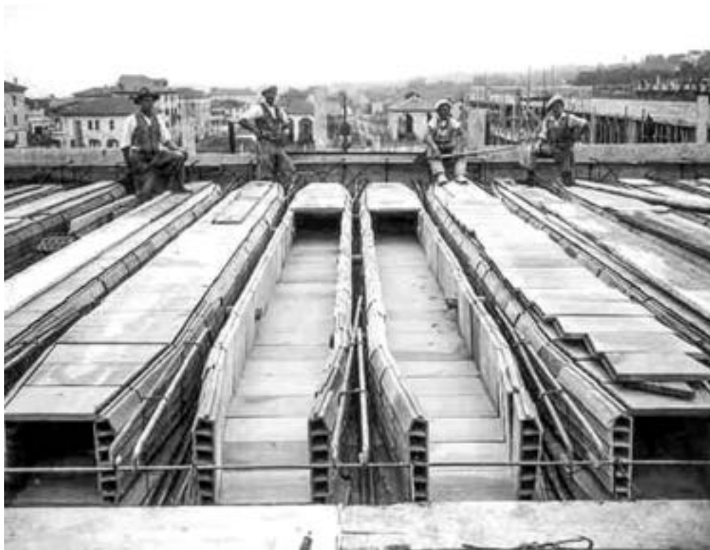
Fig.39 | Cantiere per la realizzazione di una scuola elementare a Belluno (scuola A. Gabelli). Montaggio del solaio Bidelta brevettato dalla Ditta Eredi Frazzi.
