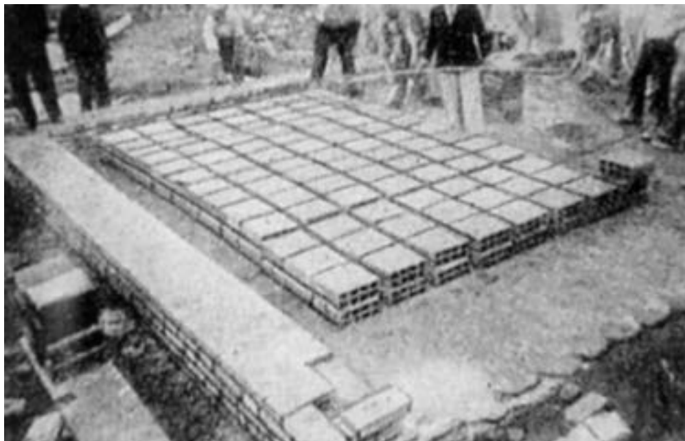
Fig.51 | Prototipo di solaio SIF (Senza Impiego di Ferro) di Miozzi. Si noti la posa del primo ricorso di laterizi e l'inizio della posa del secondo ricorso.
