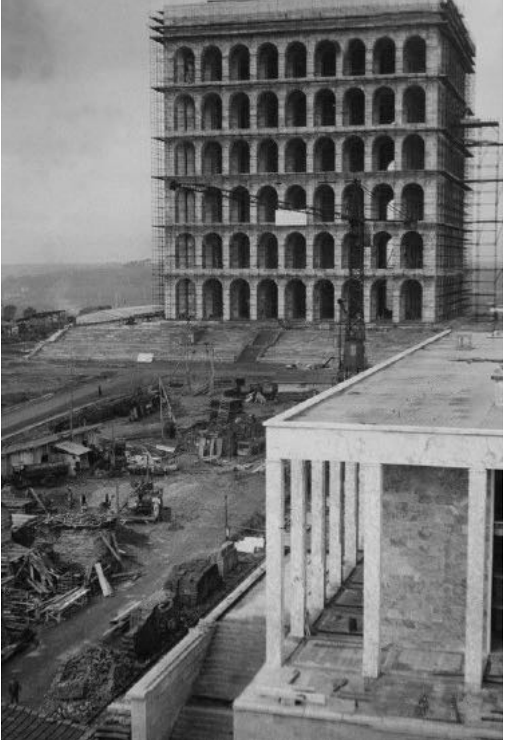
Fig.04 | Foto storica delle fasi costruttive del cantiere del Palazzo della Civiltà Italiana, progetto di Giovanni Guerrini, Ernesto Bruno Lapadula, Mario Romano, Roma, 1938-43.
