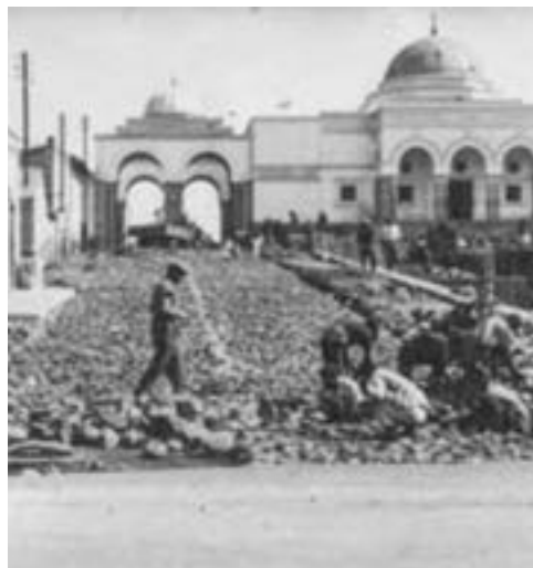
Fig.90 | Operai eritrei e italiani che posano blocchi di basalto per la realizzazione del manto stradale delle nuove strade del centro di Asmara.
