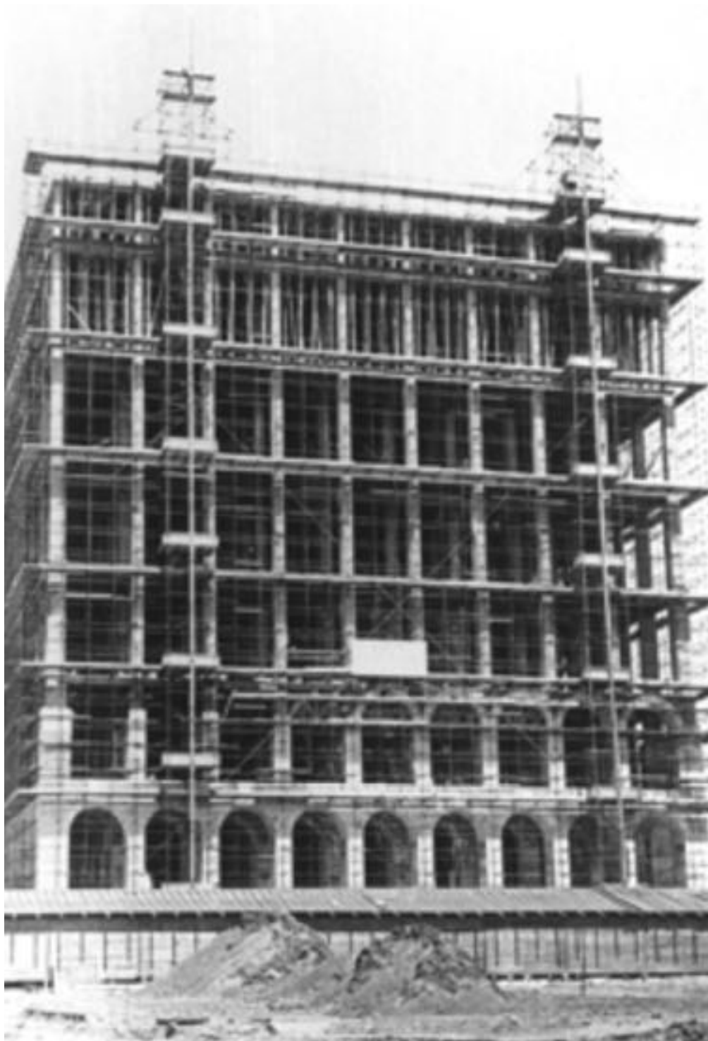
Fig.12 | Foto storica delle fasi costruttive del cantiere del Palazzo della Civiltà Italiana, progetto di Giovanni Guerrini, Ernesto Bruno Lapadula, Mario Romano, Roma, 1938-43.
