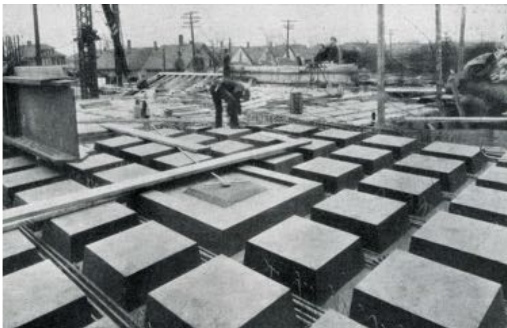
Fig.111 | Applicazione di Masonite quale materiale di alleggerimento per la realizzazione di orizzontamenti a nervature parallele in calcestruzzo armato, in Griffini E., "Costruzione Razionale della Casa - I nuovi materiali", Hoepli Editore, Milano, 1932, pag.79.
