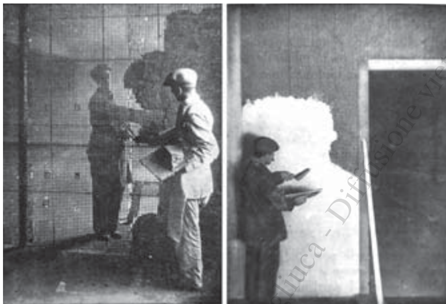
Fasi di intonacatura del Graticcio Stauss, in Società Italiana Stauss, "Graticcio Stauss. Il materiale da costruzione moderno", Istituto grafico Bertello, Cuneo, 1935, pagg.32-33.
