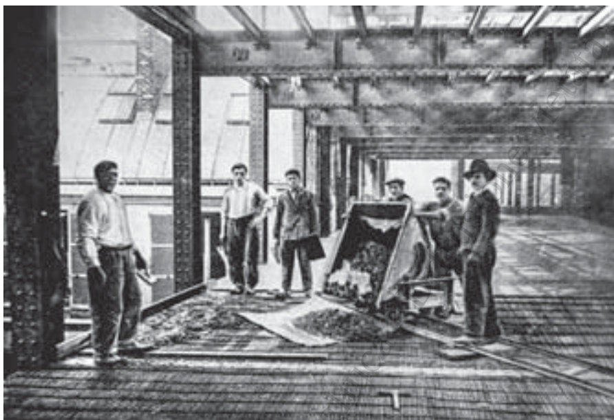
Solaio in Graticcio Stauss in una costruzione intelaiata in acciaio, in Società Italiana Stauss, "Graticcio Stauss. Il materiale da costruzione moderno", Istituto grafico Bertello, Cuneo, 1935, pag.55.
