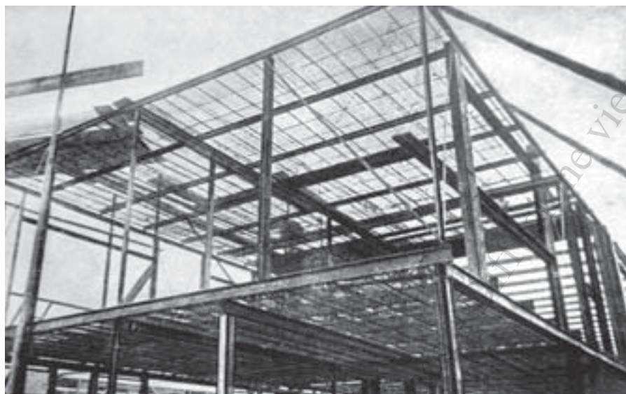
Fabbricato civile in acciaio realizzato in Graticcio Stauss, in Società Italiana Stauss, "Graticcio Stauss. Il materiale da costruzione moderno", Istituto grafico Bertello, Cuneo, 1935, pag.38.
