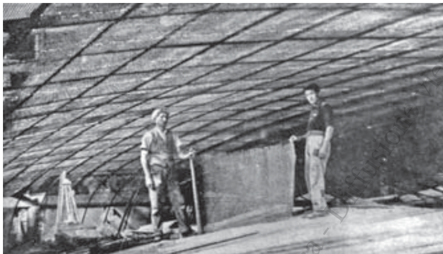
Plafone a volta del Cinema Impero di Biella realizzato in Graticcio Stauss, in Società Italiana Stauss, "Graticcio Stauss. Il materiale da costruzione moderno", Istituto grafico Bertello, Cuneo, 1935, pag.75.
