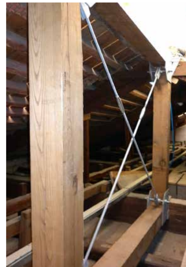
Fig. 6.33 Telaio in legno di castagno posizionato ortogonalmente rispetto al piano delle capriate
