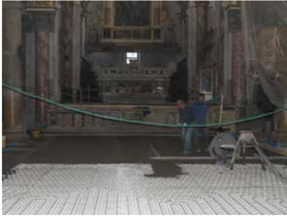
Fig. 6.29 Realizzazione di un massetto radiante con l'utilizzo del legante idraulico speciale Topcem ad asciugamento veloce Fig. 6.29 Topcem quick-during screed laid above the radiant under floor heating system
