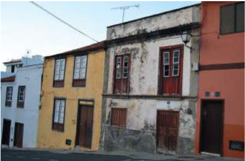
(3) Ejemplo del deterioro progresivo
