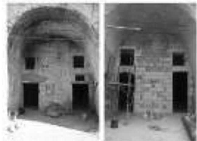
Fig.4: Sostituzione architravi. Integrazione di conci: tecnica cuci e scuci (prima e dopo)
