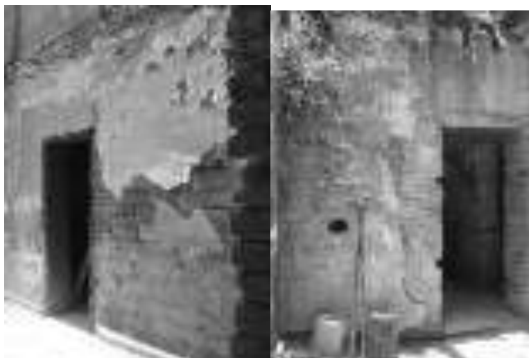
Fig. 12 Los muros presentan problemas de humedades, desprendimiento de recubrimientos, y flora parásita en zonas de los entrepisos colapsados.
