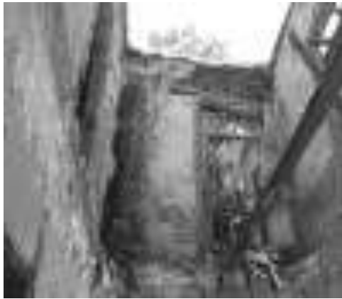
Fig. 10 Pérdida del sistema de cubiertas de enladrillado y vigería de madera.
