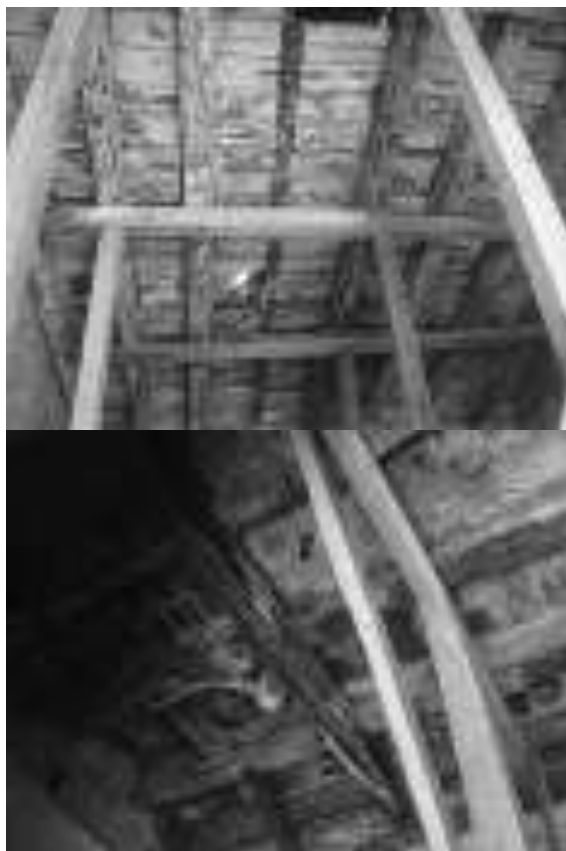
Fig. 11 Presencia de humedades en entrepisos de enladrillados y viguería de madera.
