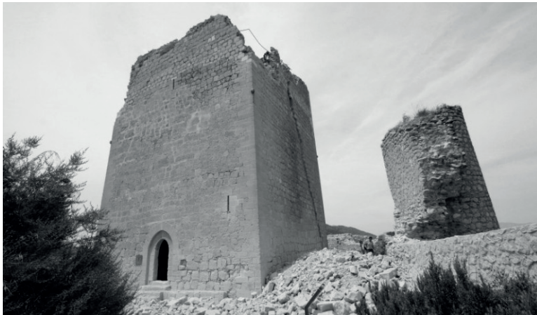
Imagen 2. Torre del Espolón. Daños por fractura de esquinas.
