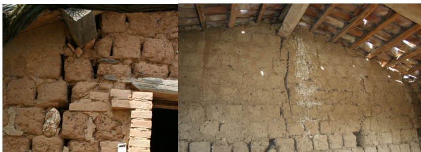
Fig. 8. Sx: Senise, Cda Bisciglieta. Danno prodotto dalla trave di copertura, che poggia direttamente sulla muratura. E' manifesta l'assenza di un dormiente. D: Chiaromonte, C.da Mancuoso. Caso analogo alla figura 9 Sx.
