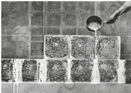
3. Colatura di malta di cemento nelle gole verticali.
