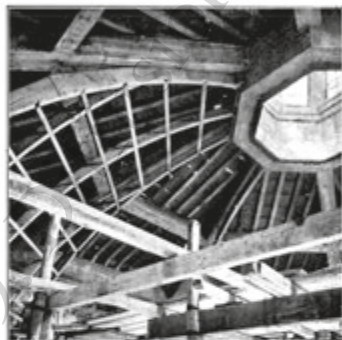
Ossatura principale in Cem. Arm. - Orditura secondaria in legno rivestite con piastre Eraclit; ottima aderenza degli intonaci, efficace difesa contro gli incendi. Prog. e Arch. Prof. Pizzetti
