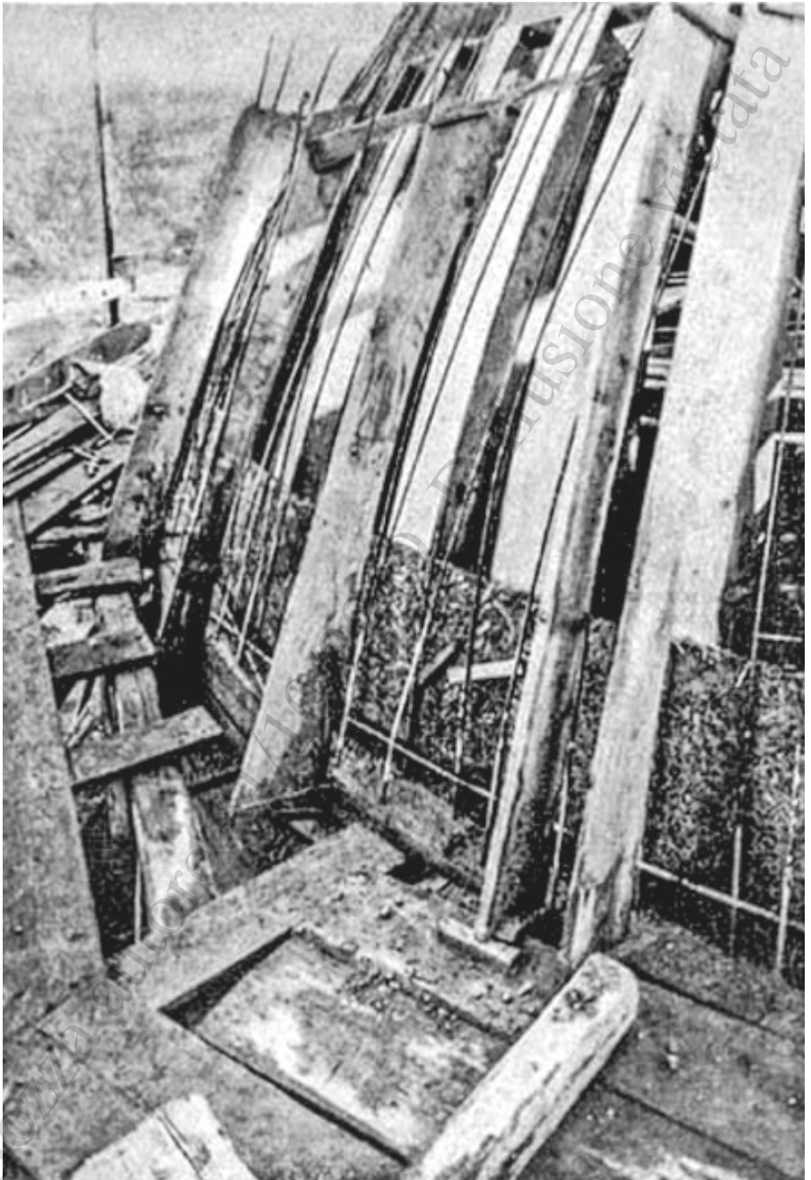
Sistema costruttivo con volta a cupola su telaio in legno e riempimento termoacustico in Eraclit nel quale viene successivamente realizzato un getto in calcestruzzo armato per la definizione della cupola, in "ARCHITETTURA - RIVISTA DEL SINDACATO NAZIONALE FASCISTA ARCHITETTI", Marzo 1932, fascicolo III, pag.151.
