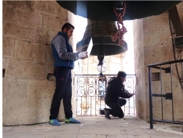
Figura 11 – Medición del ancho de fisuras en las Torre Este de la Catedral.
