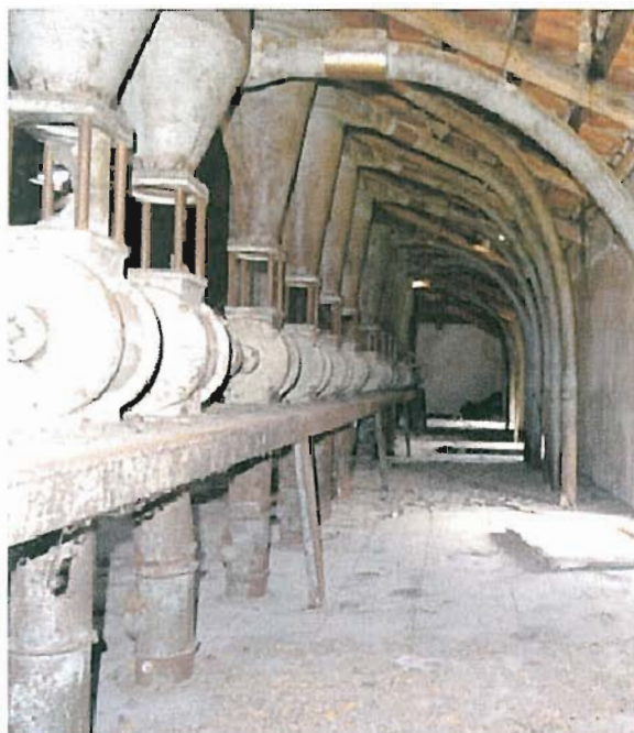
Fig. 3: Sottotetto con macchine per funzionamento elettrico a cilindri.
