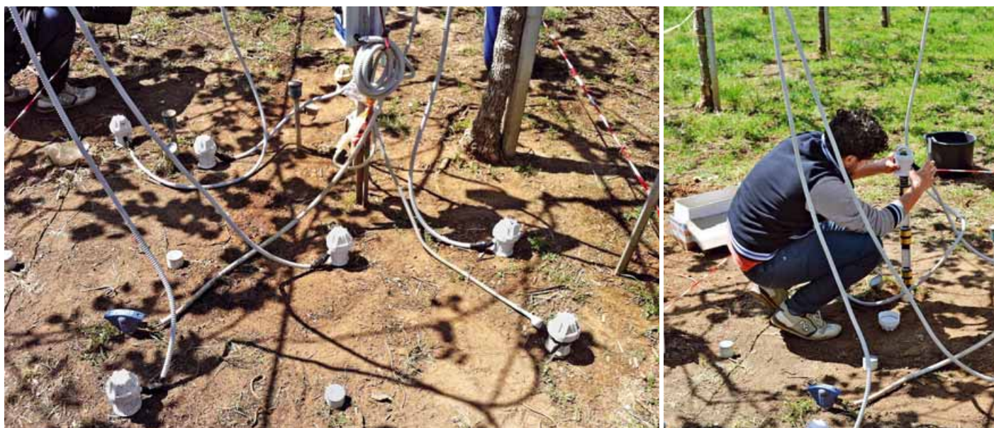
Foto 1 A sinistra : veduta delle sonde installate nel sito sperimentale a formare un reticolo per il monitoraggio dinamico dell'umidità del suolo; a destra : momento dell'alloggiamento di una delle sonde Fdr all'interno del pozzetto
