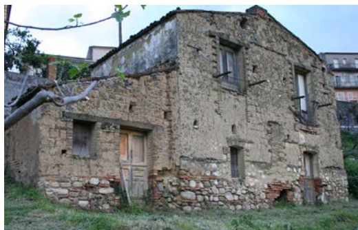
Figura 4. Erosione prodotta dalle acque meteoriche sulla parete nord dell'edificio in ciuci in Via Persiani Aquilante a Senise. Fonte: archivio privato Sileo Antonio - Forlenza Giovanna.
