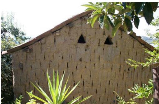
Figura 5. Erosione dei blocchi di adobe dovuti al ristagno in corrispondenza del punto di attacco tra il basamento ed il primo filare di mattoni. Fonte: archivio privato Sileo Antonio - Forlenza Giovanna.
