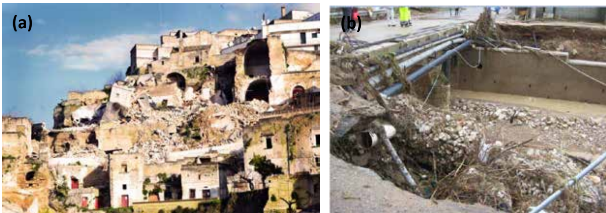
Figura 9: a) Crollo abitazioni nel Comune di Ginosa; b) Ponte danneggiato sulla strada SP 1 per Montescaglioso.
