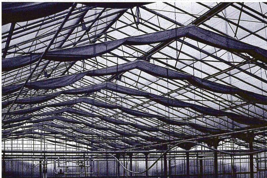
Fig. 7 - Teli interni di ombreggiamento e schermo termico.
