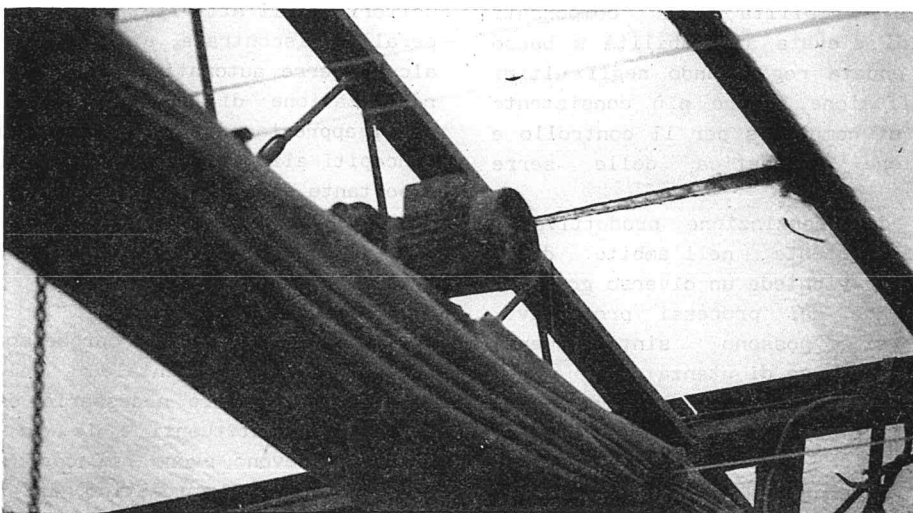
Fig. 3 : Teli interni di ombreggiamento e schermo termico.
