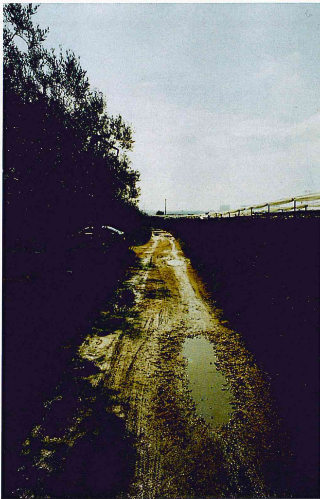
Fig. 4 - Condizioni delle strade rurali prima dell'intervento di sistemazione ed ammodernamento.
