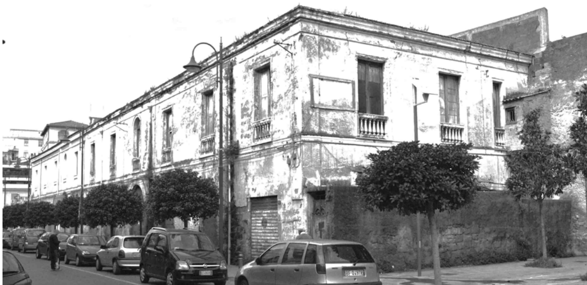
Figura 1 - Prospetto Est (lato corto) e prospetto Sud (lato lungo) del fabbricato oggetto di studio.
