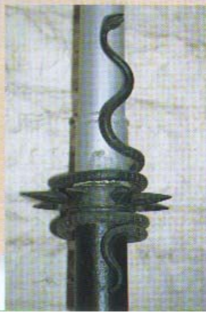
Fig. 31 Palazzo dell'Acquedotto Pugliese, anno, borse d'acqua ai tubi di gronda.
