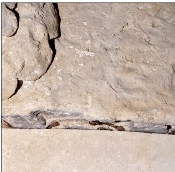
Fig. 6. - Matera, chiesa di Santa Maria la Nova: intercapedine di circa cm 3 emersa tra i due architravi monolitici, con la decorazione a mastice rosso 'ritrovata' e ancora ben conservata. In questo spazio sono stati raccolti frammenti erratici di amalgama (foto S. Schiattone, N. Iacopino - 2022).
