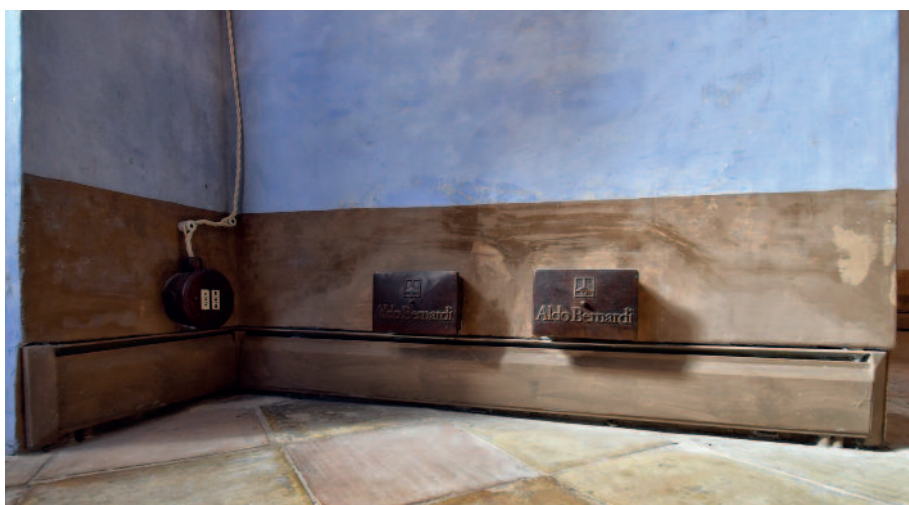
Fig. 5 - Matera, casa Noha nella parte alta del Sasso Caveoso: particolare del sistema a battiscopa radiante con struttura in alluminio verniciato (foto di Roberto Nadalin).
