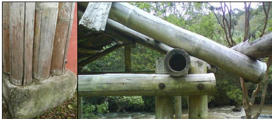
Figura 51 Mantenimiento inadecuado en viviendas en caña Fuente: (Inza arquitectura, 2022)
