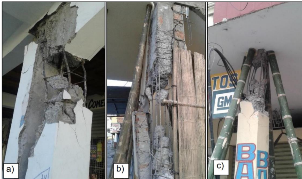
Figura 42 Fallas por falta de confinamiento en columnas. a) Estribos muy separados. b) estribos de 8 mm. c) No se aprecia el estribo Fuente: (Aguilar, 2016)
