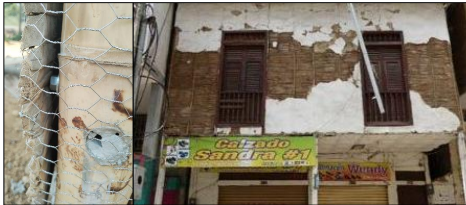
Figura 52 Desprendimiento de recubrimientos en viviendas en caña Fuente: (Autor de la investigación y Alfaro, 2021)
