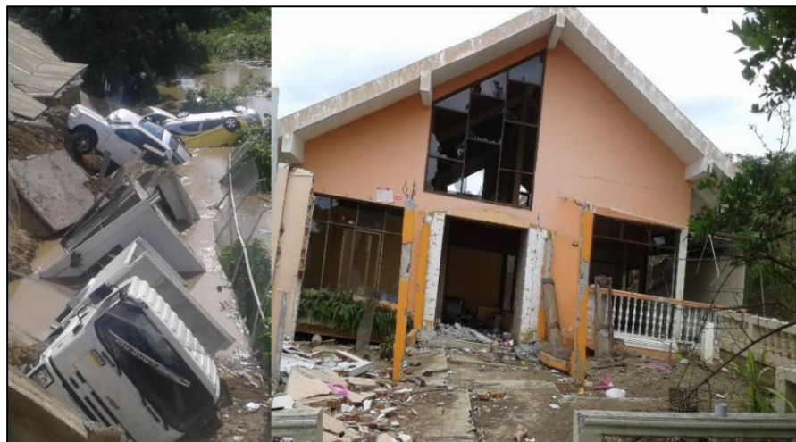
Figura 45 Fallas estructurales por licuefacción de suelos Fuente: (Aguiar, 2016)
