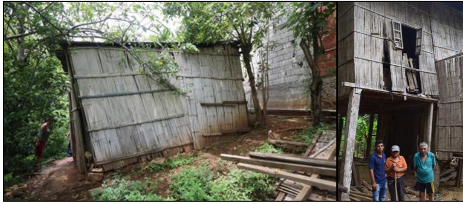
Figura 46 Desplazamiento de mamposterías de viviendas en caña Fuente: (Web, 2021)
