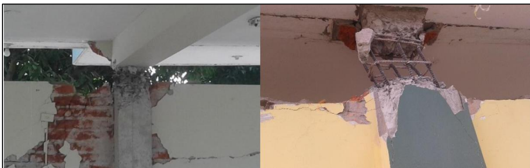
Figura 40 Daños por columna corta registrado en Portoviejo Fuente: (Aguar, 2016)
