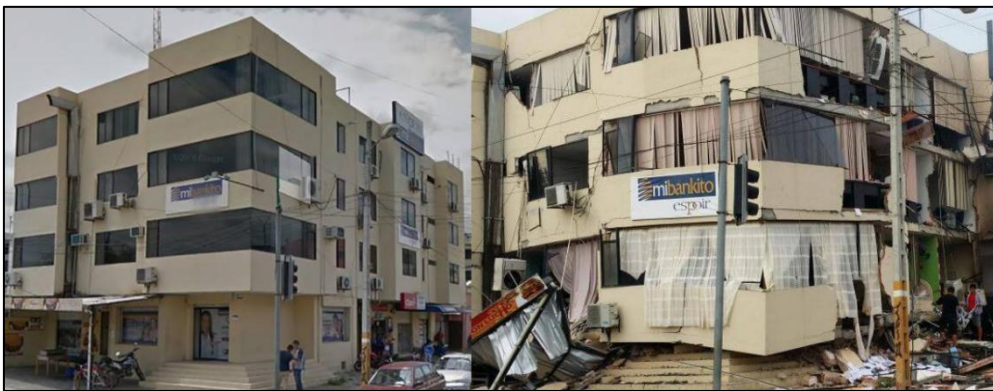
Figura 43 Fallas por piso blando. Edificio antes y después del terremoto Fuente: (Aguar, 2016)
