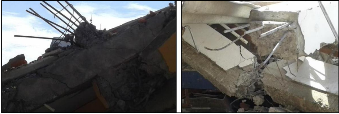
Figura 44 Columna con traslape y detallado deficiente Fuente: (Aguiar, 2016)
