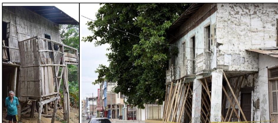
Figura 53 Estructuras sin protección de aleros en viviendas en caña Fuente: (Alfaro, 2021)
