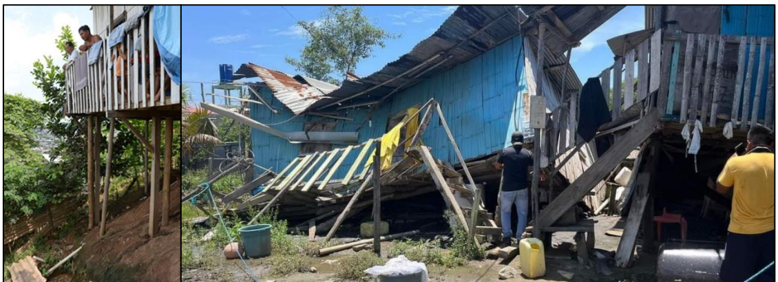
Figura 47 Inexistencia de cimientos en viviendas en caña Fuente: (Web, 2021)
