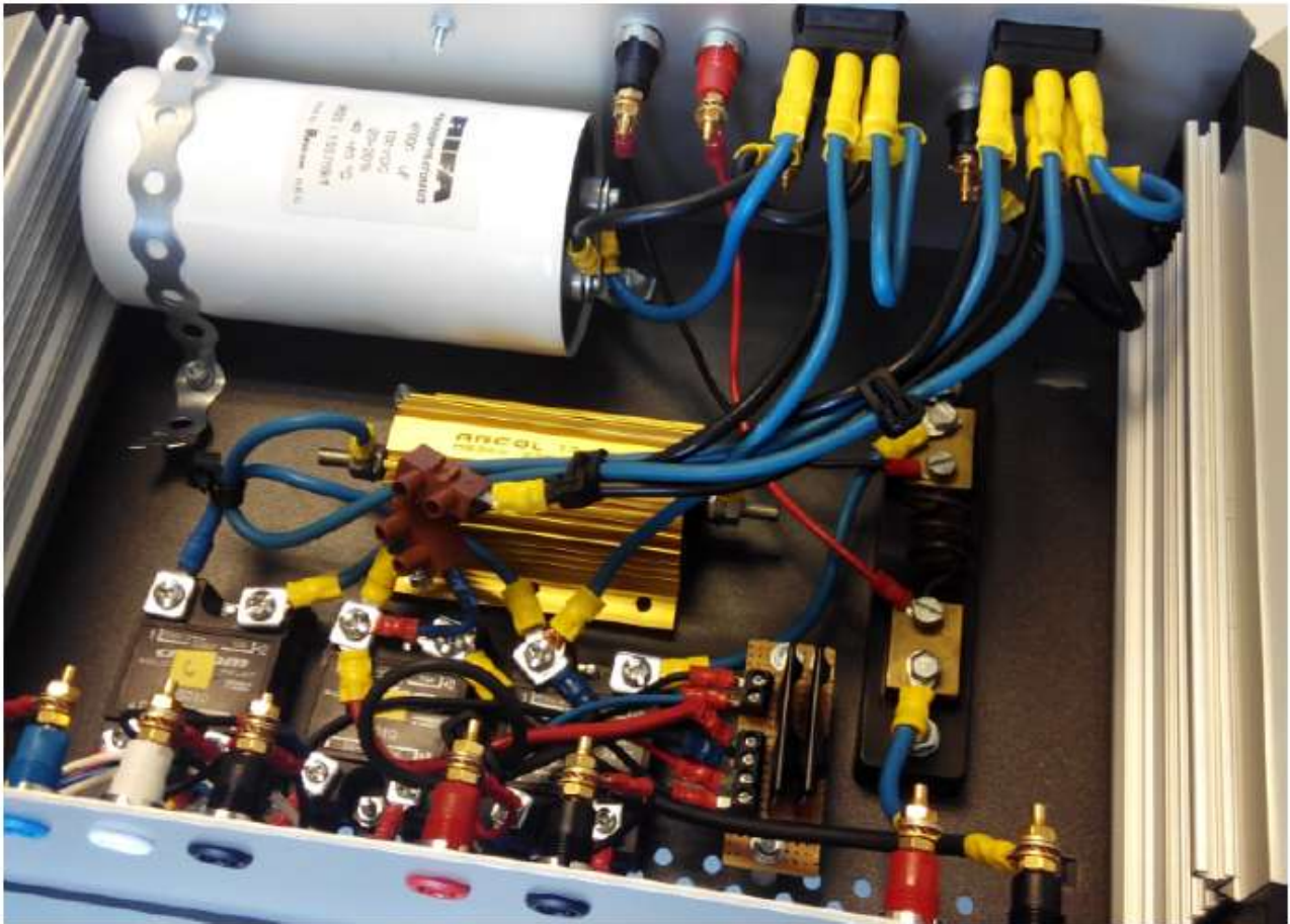
Figura 92. Circuito di misura per i moduli. In evidenza il carico capacitivo in alto a sinistra.
