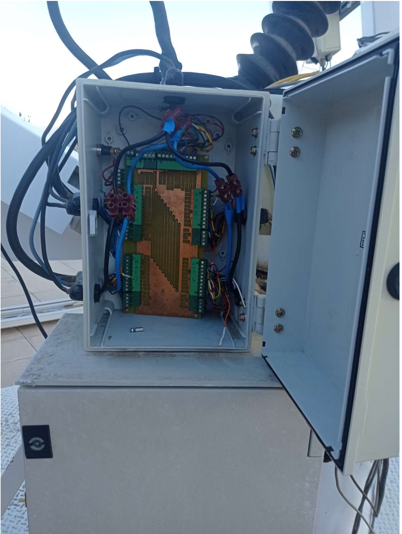
Figura 91. Sistema sperimentale situato presso l'università di Jaén – dettaglio della scheda elettronica di misura.
