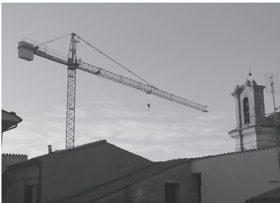
Figura 6. Una gru all'opera per la ricostruzione del centro storico, nei pressi della chiesa di Santa Maria del Soccorso. Penna Sant'Andrea, 31 gennaio 2023 (foto di Gianfranco Spitilli).
