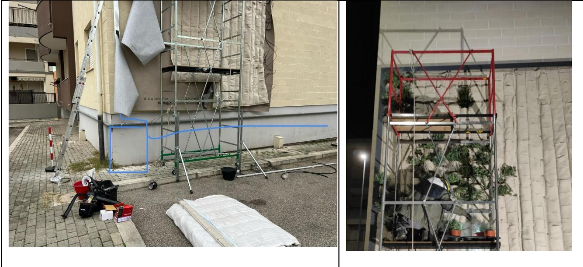
Fig. 17 Fasi di montaggio della parete verde e di messa a dimora delle piantine.
