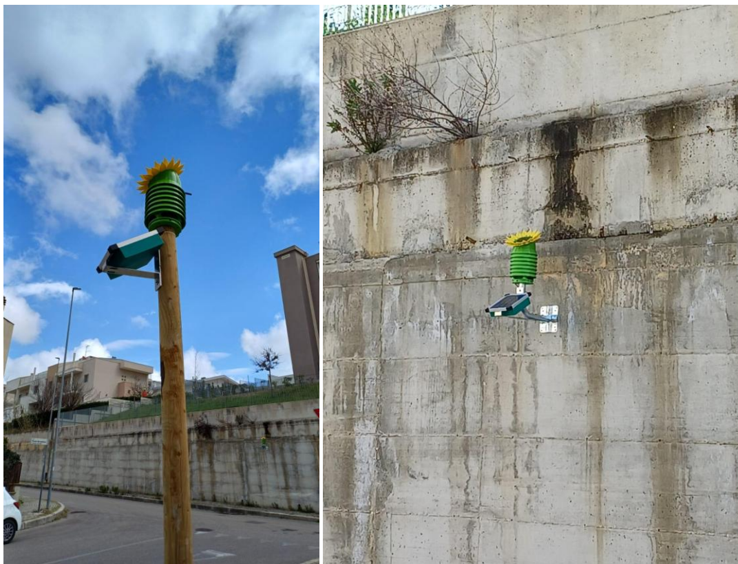
Fig. 52 Installazione del sistema monitoraggio della qualità dell'aria e campagna di monitoraggio, all'inizio della sezione.
