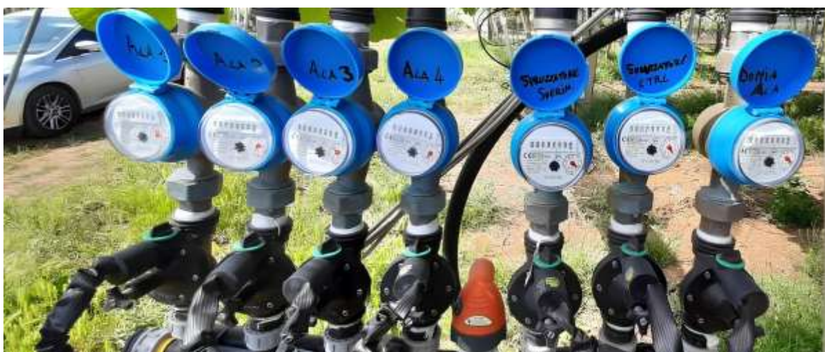
Fig. 14 Set di elettrovalvole a funzione indipendenti installate nella tesi 4DL
