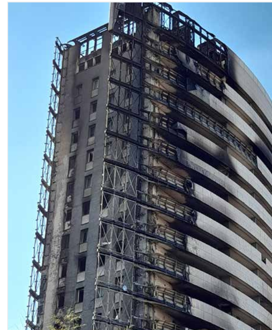
Figura 2 - Facciata della Torre dei Moro dopo l'incendio.
