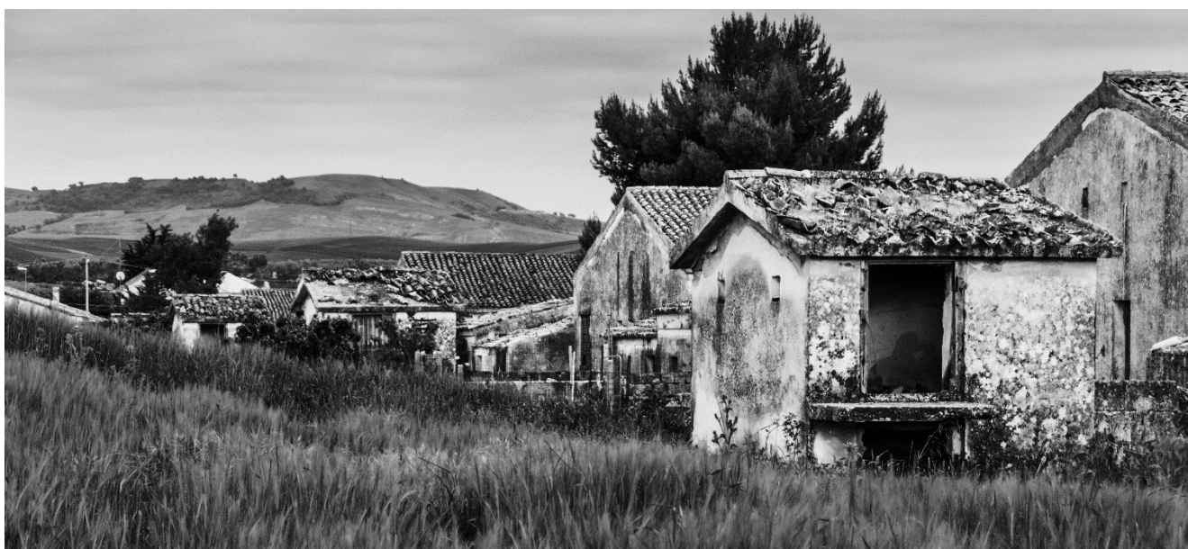
Fig. 5 – Facciate esterne fortemente degradate
