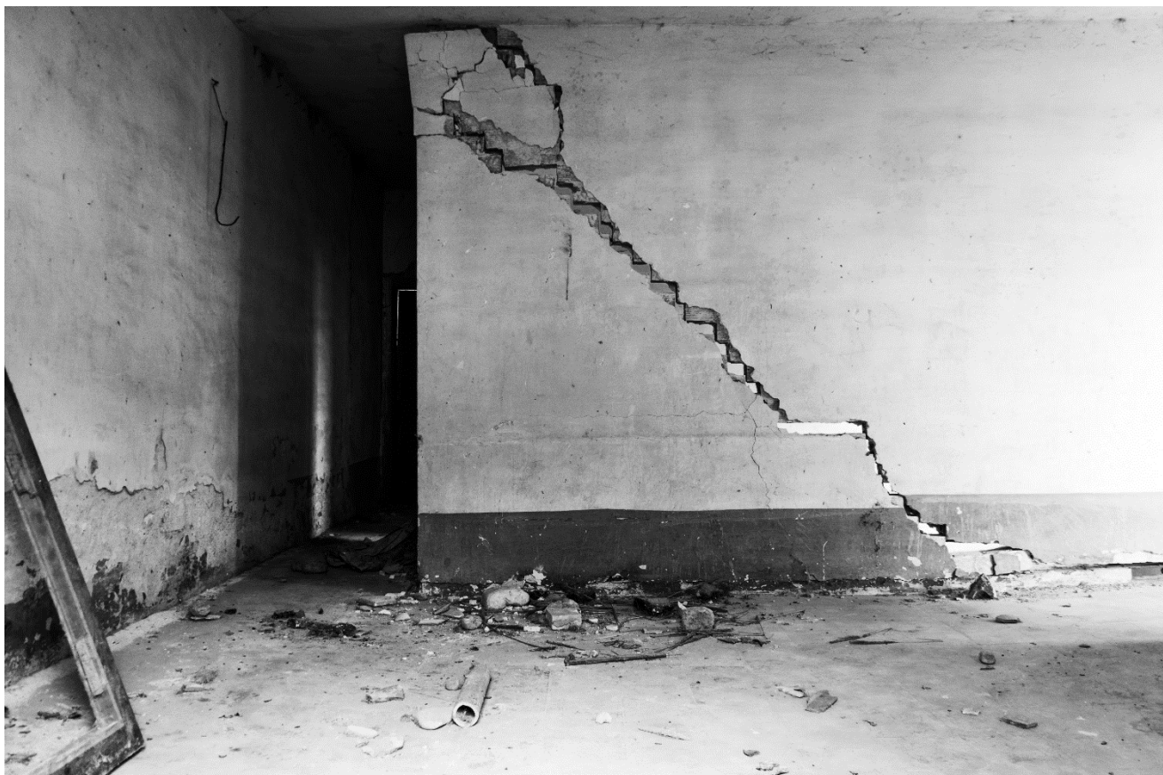
Fig. 4 – Esempio emblematico della tipologia di fessurazioni rilevate
